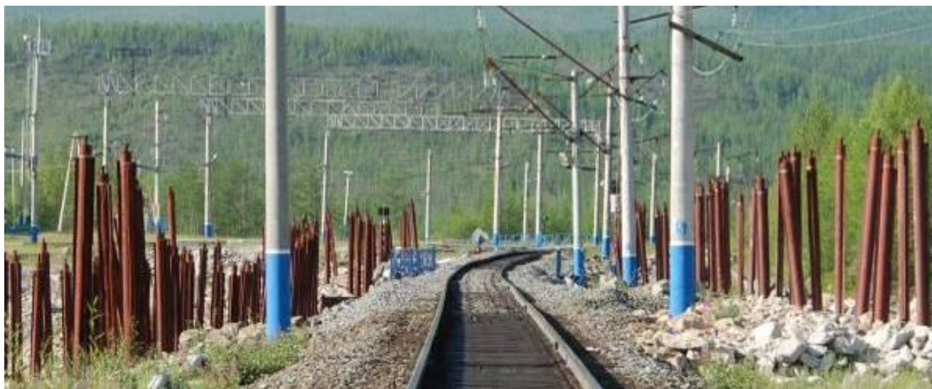
Рис. 2. Деформации пути Восточно-Сибирской ж.д., 1374 км БАМ, июль 2011 г
