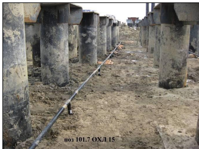
Рис.6. Термостабилизация системами ВЕТ в основании производственного корпуса на Бованенковском нефтегазоконденсатном месторождении
