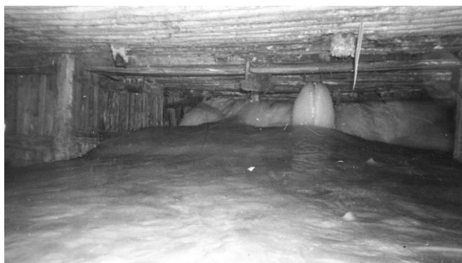
Рис. 2. Заполненное льдом подполье под главным корпусом. Фото Н.И. Новикова, 27 марта 1986 г.
