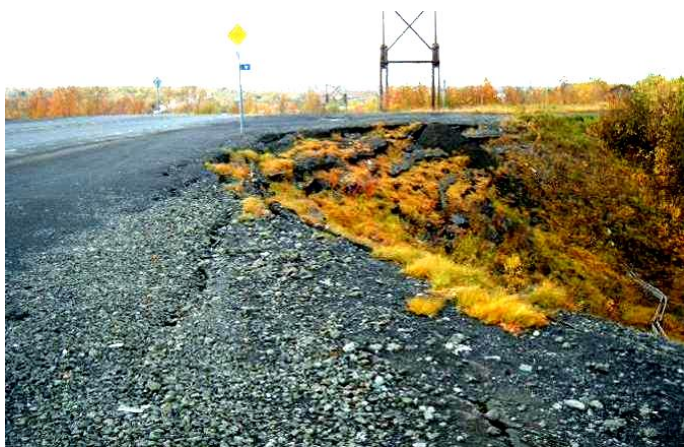
Рис. 7. Ступенчатое отседание основной площадки насыпи автомобильной дороги «Норильск – Талнах»
