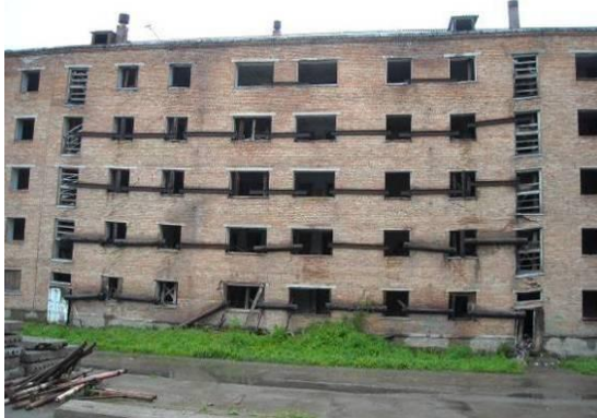
Рис.7. Деформации жилого дома в 1-м микрорайоне г. Игарка (июль 2010 г.) при снижении несущей способности вмороженных свай
