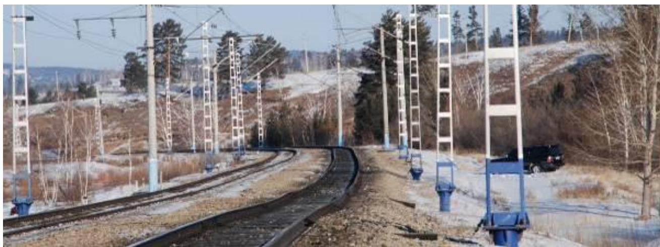
Рис. 1. Деформации пути Забайкальской ж.д., 6278 км, февраль 2011 г
