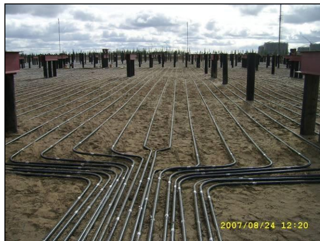
Рис.4. Термостабилизация системами ГЕТ в основании производственного корпуса (116,2 x 66 м) на Ванкорском нефтяном месторождении
