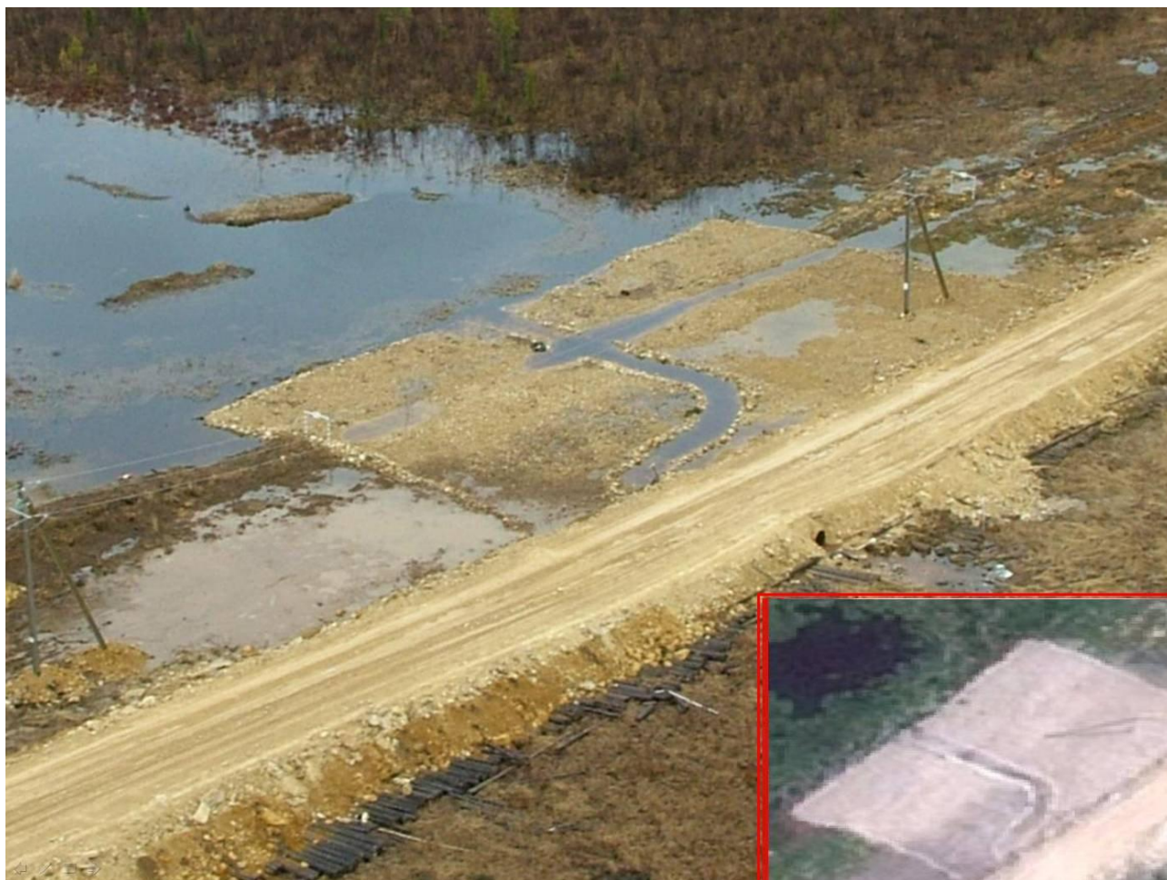
Рисунок 1. Развитие термокарста по противоэрозионной гравийной подсыпке. В правом нижнем углу на аэрофотоснимке показан этот же участок восемь месяцев ранее (признаков термокарста не наблюдается)
