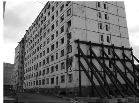
Рис.8. Жилой дом по ул. Лауреатов в г. Норильске. Неравномерные осадки вмороженных свай при отеплении и частичном протаивании вмещающих вечномерзлых грунтов, август 2009 г.
