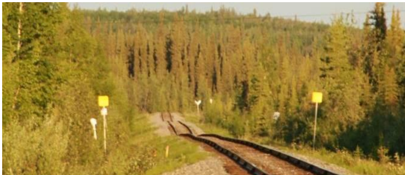
Рис. 3. Деформации пути Аляскинской ж.д., район Фербенкса, июль 2008 г.
