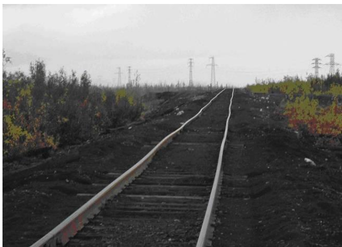
Рис. 5. Характер деформаций на участке низкой насыпи
