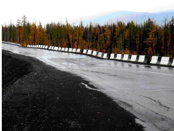
Рис. 4. Формирование локальной просадки на автомобильной дороге «Норильск – Талнах»
