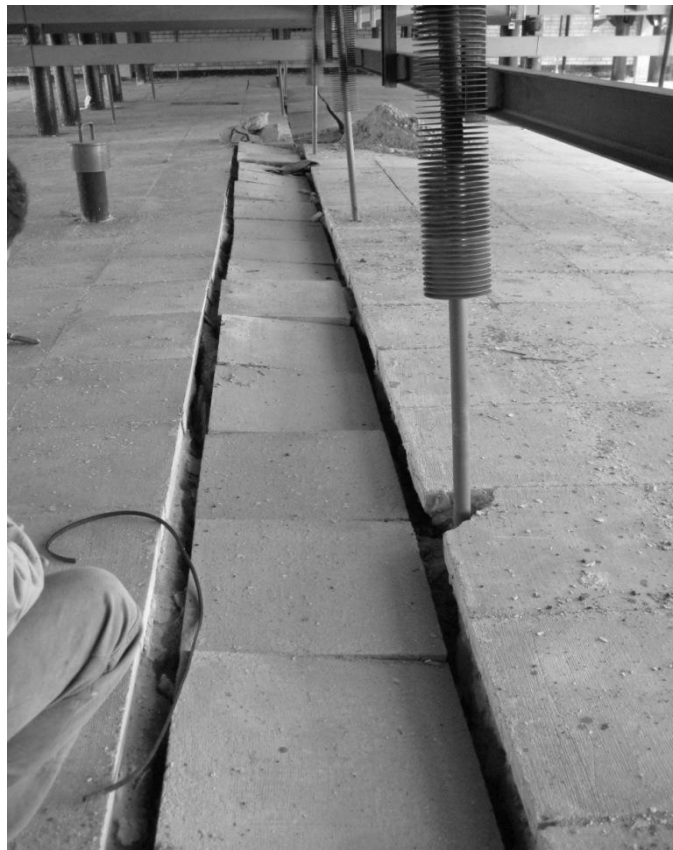
Рис 3. Растрескивание грунта вдоль продольной оси в проветриваемом подполье.
