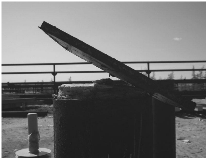
Рис 2. Отрыв оголовка сваи за счет пучения песчано-цементного раствора внутри сваи диаметром 159 мм.
