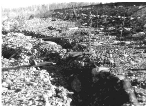
Рис.4. Перемещающаяся часть насыпи с трещинами на обочине
