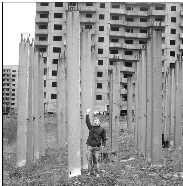
Рис.1. Сваи, выпученные за счет морозного пучения в деятельном слое при отсутствии нагрузки. Оганер (пригород Норильска), июль 2010 г.
