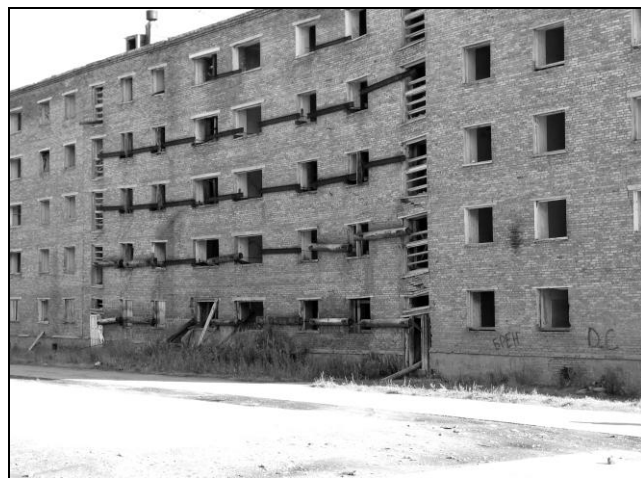
Рис.1. Мероприятия, направленные на предотвращение деформаций жилого дома в 1-ом микрорайоне. Центральная часть дома тянет за собой крайние. (Фото С.В. Познарковой, июль 2010).
