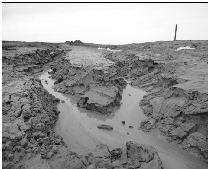
Рис.1. Эрозионный размыв супесчаных грунтов СТС при снятии торфяного слоя
