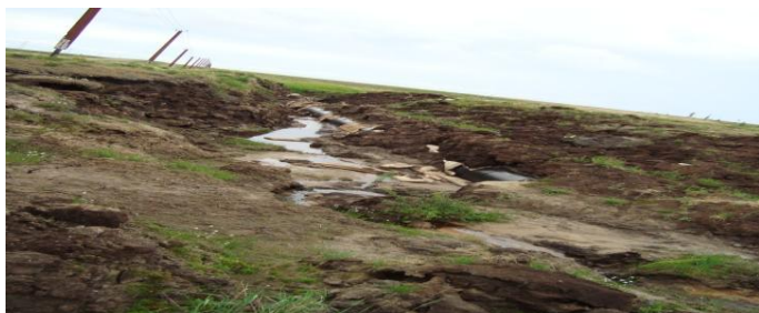
Рис.1. Оголение подземного газопровода на территории ГП «Юбилейное» при развитии термоэрозии, июль 2009 г.
