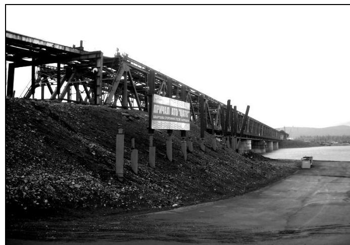
Рис.1. Деформированный автожелезнодорожный мост через р. Норильская. По контуру левой опоры моста устроены парожидкостные установки термоустановки глубокого заложения (Фото А. Маслакова, июль, 2010 г).
